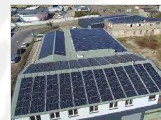
Deutschland Dachfläche in Betrieb 1.06 MWp
