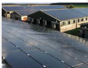
Deutschland Dachanlage in Betrieb 580 kWp
