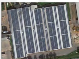
Deutschland Dachanlage in Betrieb 929 kWp
