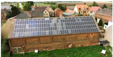
PVA Pegau 30 kWp Prognose: 1010,01 kWh/kWp Ø der letzten 4 Jahre: 1109,36 kWh/kWp
