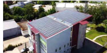
PVA Offenburg 56 kWp Prognose: 918,2 kWh/kWp Ø der letzten 4 Jahre: 1039,62 kWh/kWp
